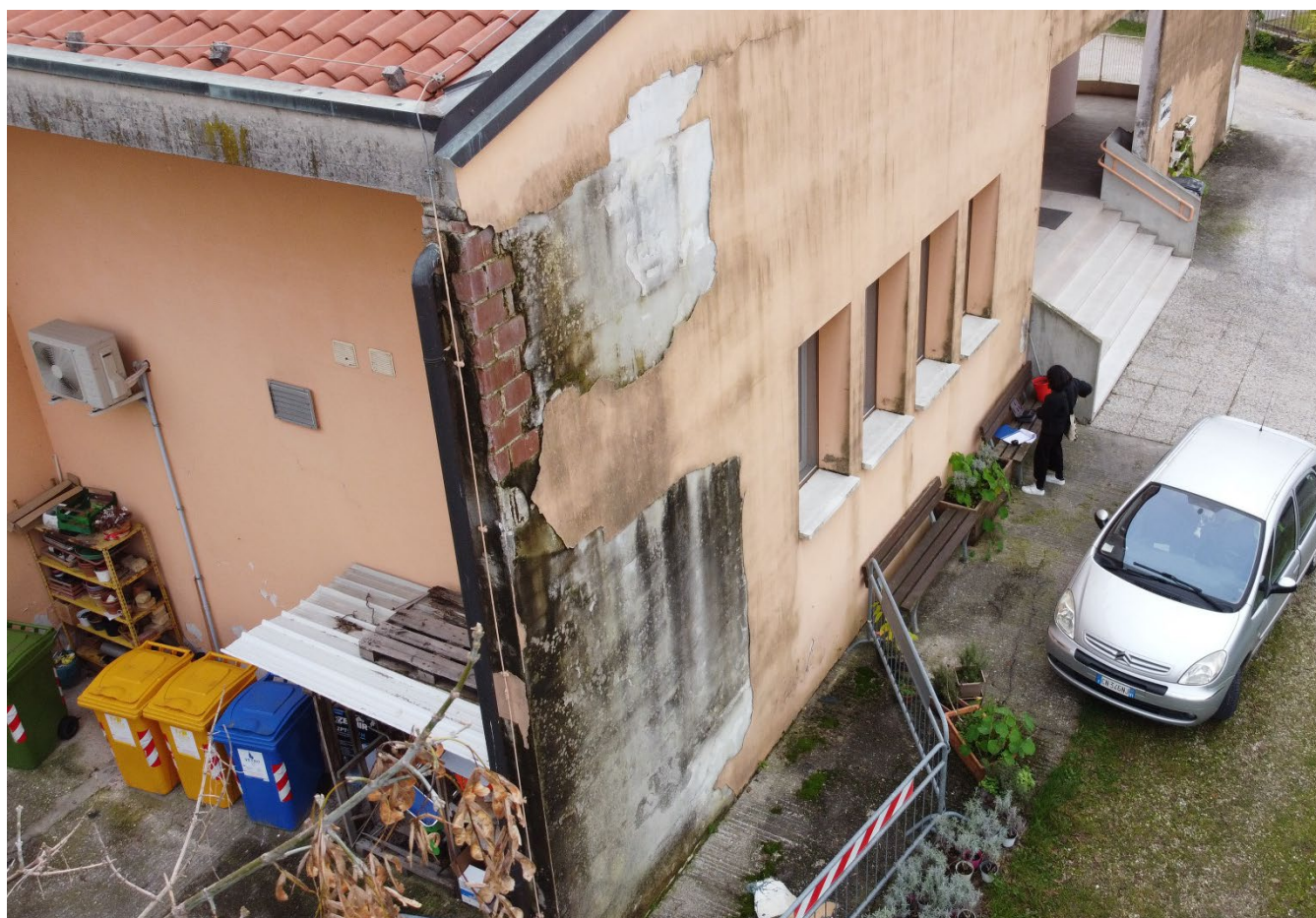
Dettaglio dell'ammaloramento nell'angolo nord-est
