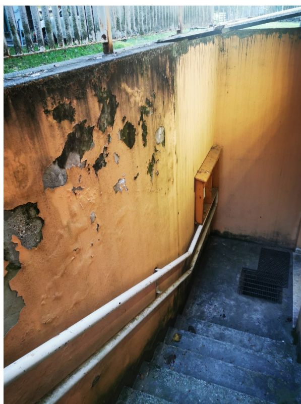
Dettaglio degli intonaci ammalorati sul fronte sud
