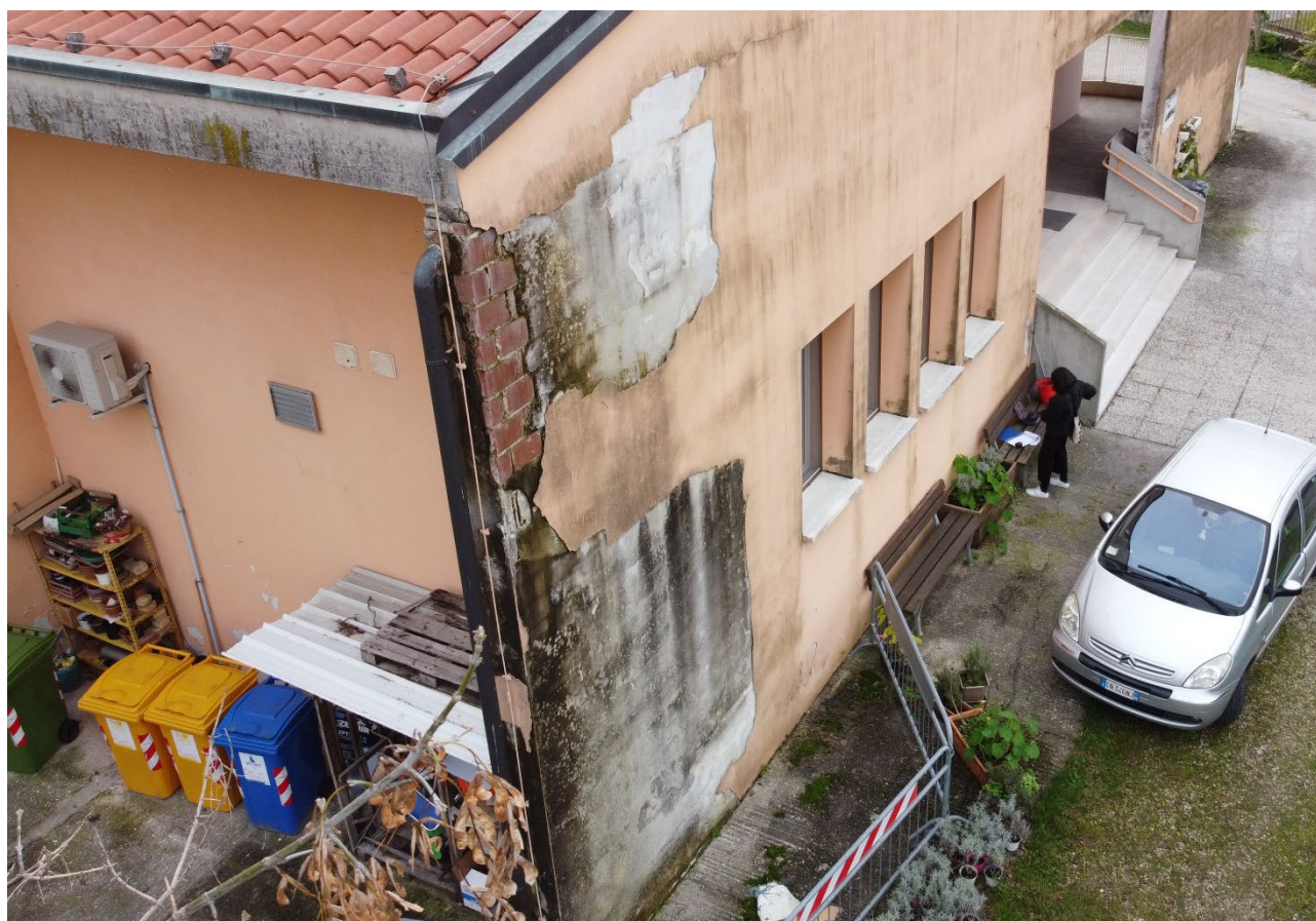
Dettaglio dell'ammaloramento nell'angolo nord-est
