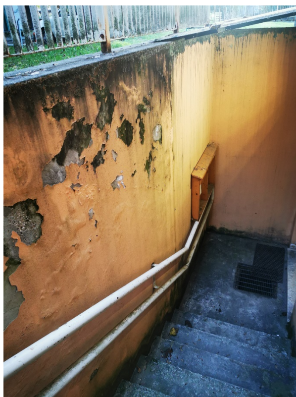
Dettaglio degli intonaci ammalorati sul fronte sud
